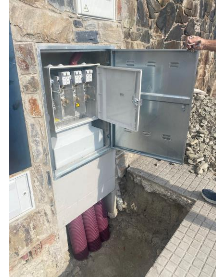
Tubulares y canal
